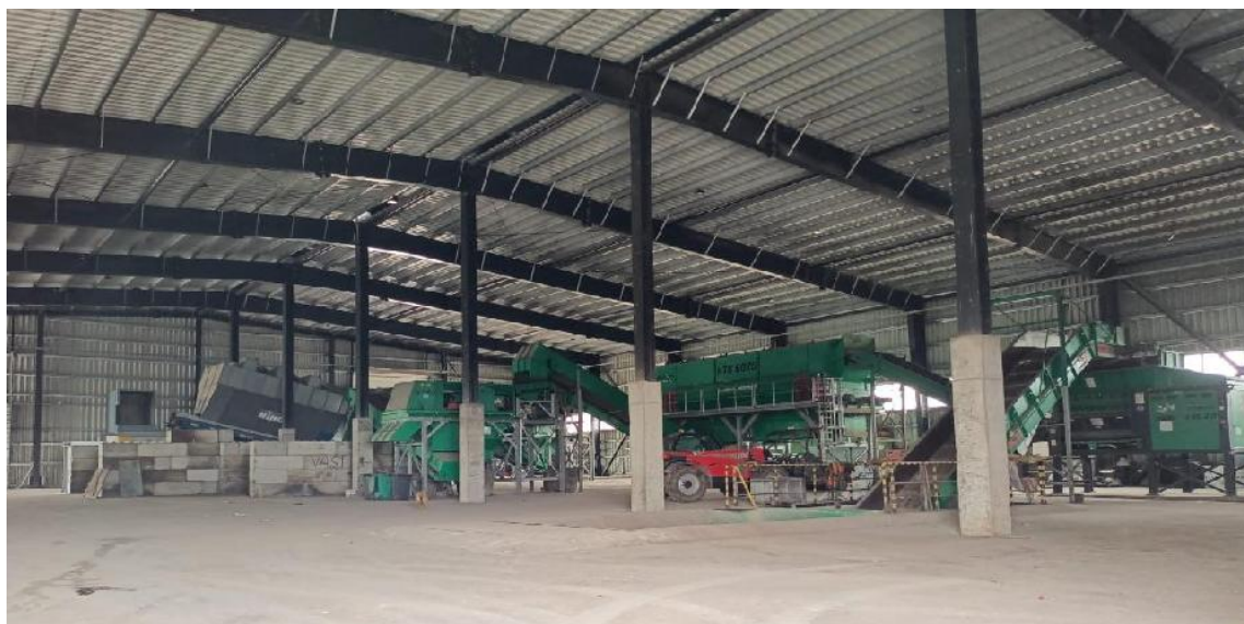
Foto 1: Instalatia de tratare mecanica – vedere interioara
