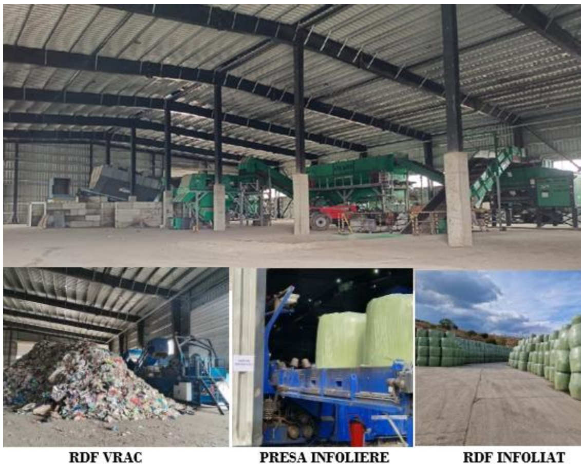
Foto 2: Instalatia de tratare mecanica – vedere interioara
